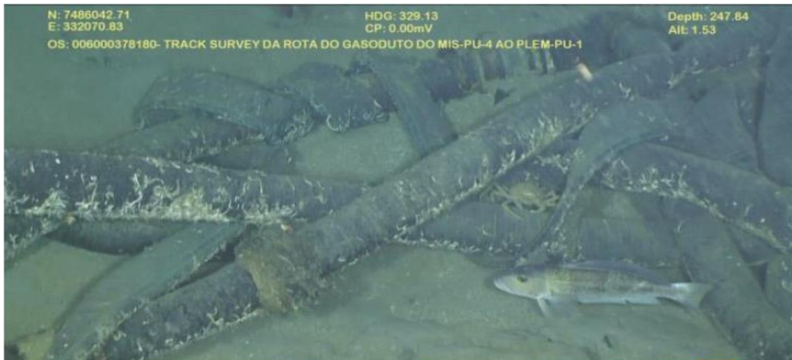
Figura 95: Exemplo de cruzamento múltiplo entre linhas flexíveis que compõem um arranjo submarino instalado há muitos anos na bacia de Campos. Fonte: Projeto de descomissionamento da Plataforma Semissubmersível P-15, da Petrobras. Abril/2020.
